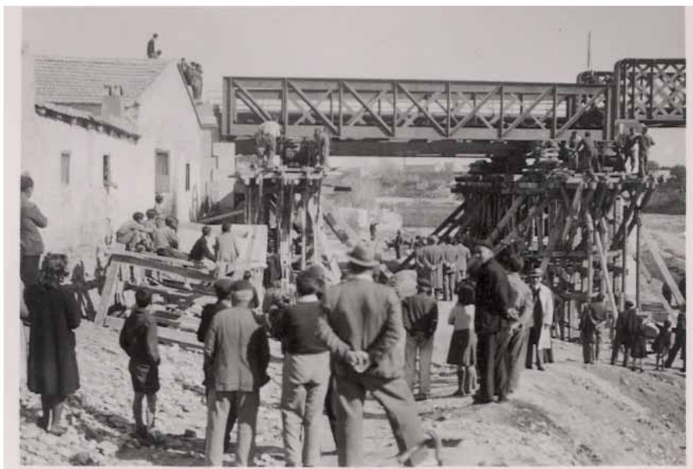
Fig. 3. Sustitución de tramo metálico en el puente sobre el río Seco en la línea A.V.T., (Castellón), ca. 1915. Biblioteca-Arxiu de la Diputació Provincial de Castelló
