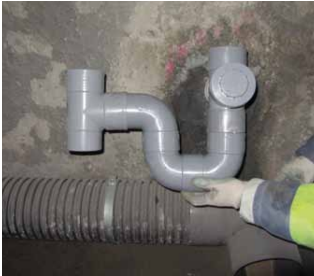
Fig. 24. Dispositivo tipo sifón empleado, en el ensayo experimental en desarrollo para impedir la entrada de aire en los nuevos drenes subhorizontales de captación
