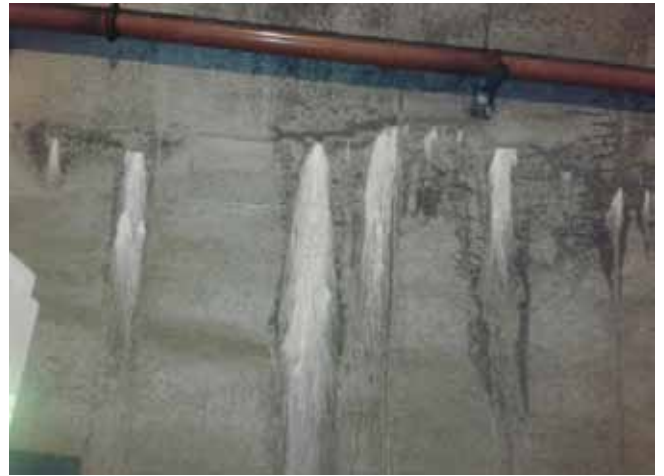
Fig. 6. Filtraciones que generaban presencia de agua sobre el pavimento
