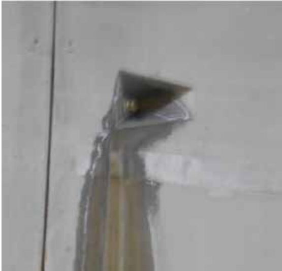
Fig. 15. Filtraciones en tornillo de unión dovelas
