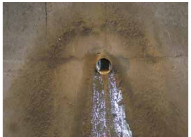
Fig. 20. Aporte de agua a través de los drenes de los hastiales
