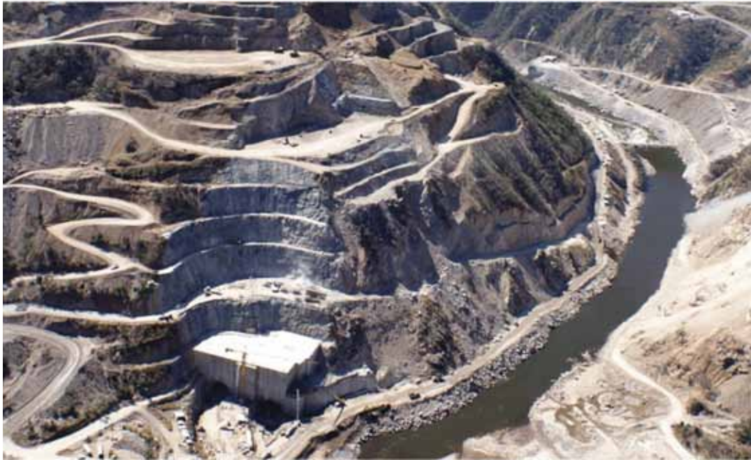
Fig. 11. Vista de la ladera con las sucesivas excavaciones en su parte superior y el monolito de hormigón en la base del deslizamiento
