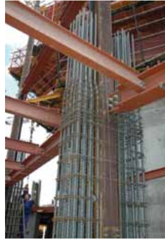
Fig. 2. Uniones atornilladas y disposición de extremo de las vigas metálicas para facilitar la ejecución de los nudos
