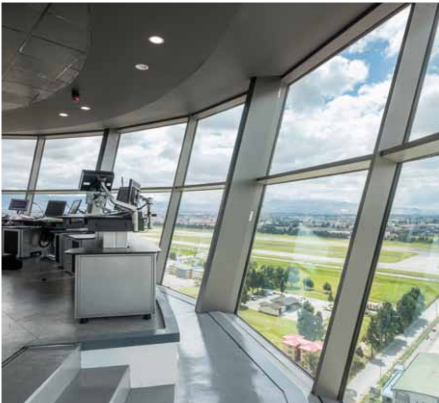
Interior del edificio de gestión y control
