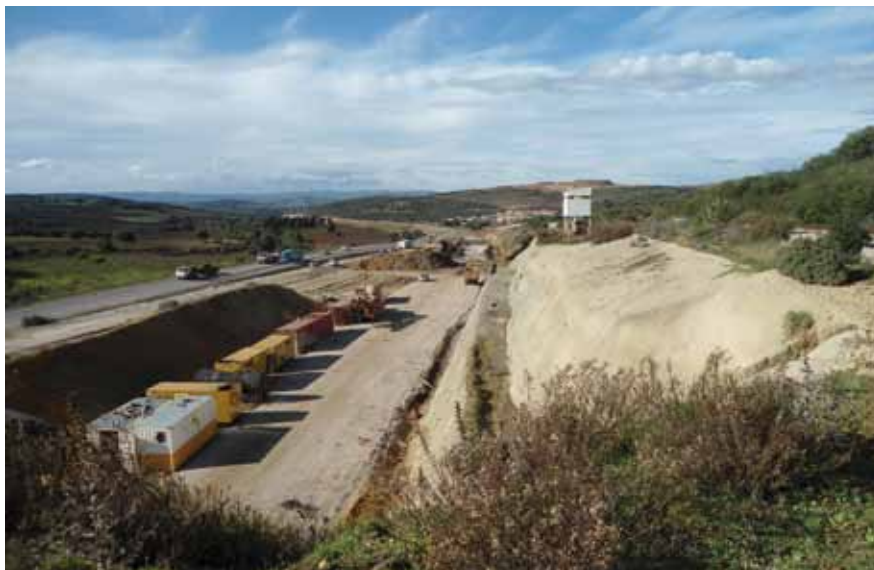
Construcción de una vía ferroviaria entre las ciudades de Annaba y Ramdane Djamel (OHL)
