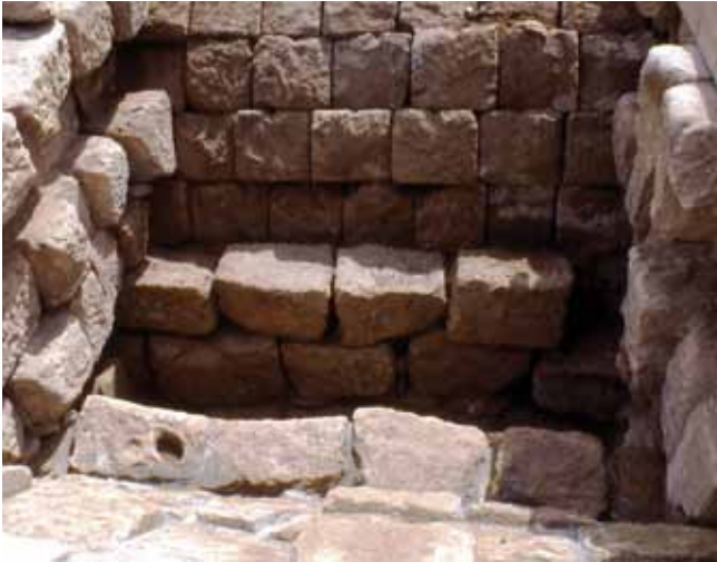
Fig. 19. Refuerzo interior de las bóvedas con unas hiladas de sillares adosadas a la rosca para mejorar su estabilidad en la Ponte Freixo, Ourense (Foto M. Durán)
