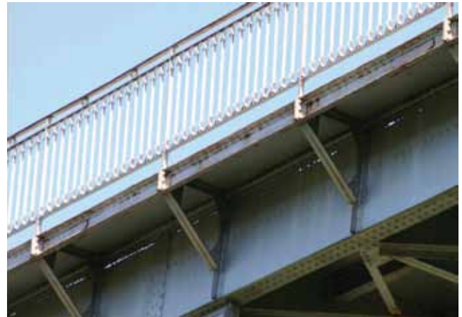
Fig. 9. Corrosión en almas de vigas principales con pérdida de sección
