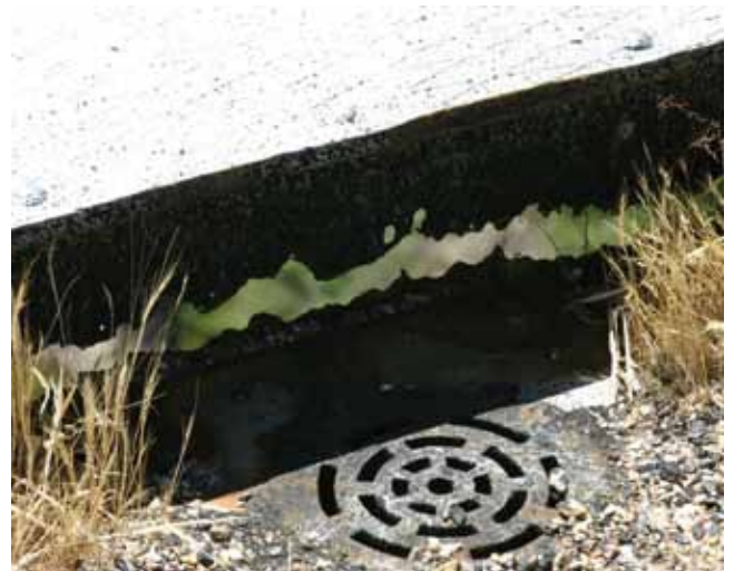
Fig. 10. Zona dañada por la corrosión
