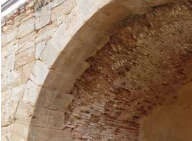
Fig. 13. Pérdida de durabilidad de una bóveda de ladrillo
