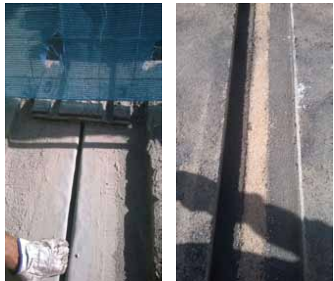
Fig. 2. Ejecución de banda de estanqueidad bajo junta de perfil de elastómero (izquierda) y bajo junta de betún modificado con protección de arena (derecha)
