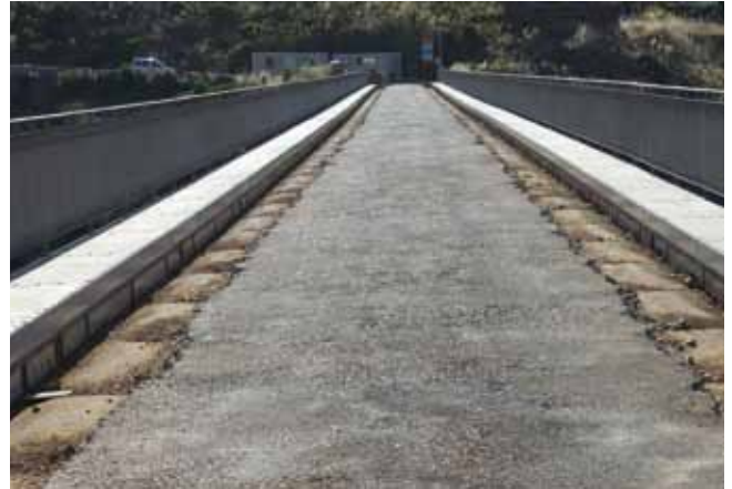
Fig. 19. Aspecto del tablero una vez concluida la rehabilitación de las vigas principales
