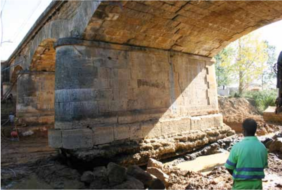
Fig. 12. Socavación de la pila de un puente ferroviario
