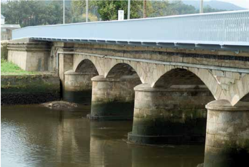
Fig. 17. Aspecto del puente de Ponteceso, ensanchado y documentado, pero con una conducción intrusa que no fue posible reubicar
