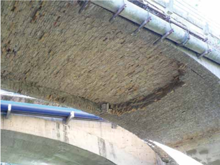
Fig. 18. Desprendimiento de la hoja de intradós de un puente de ladrillo
