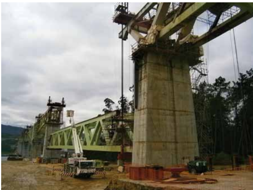
Figs. 4a, 4b y 4c. Secuencia del proceso de izado de los vanos laterales 10, 11 y 12, vista del izado del vano 12 y del vano 10
