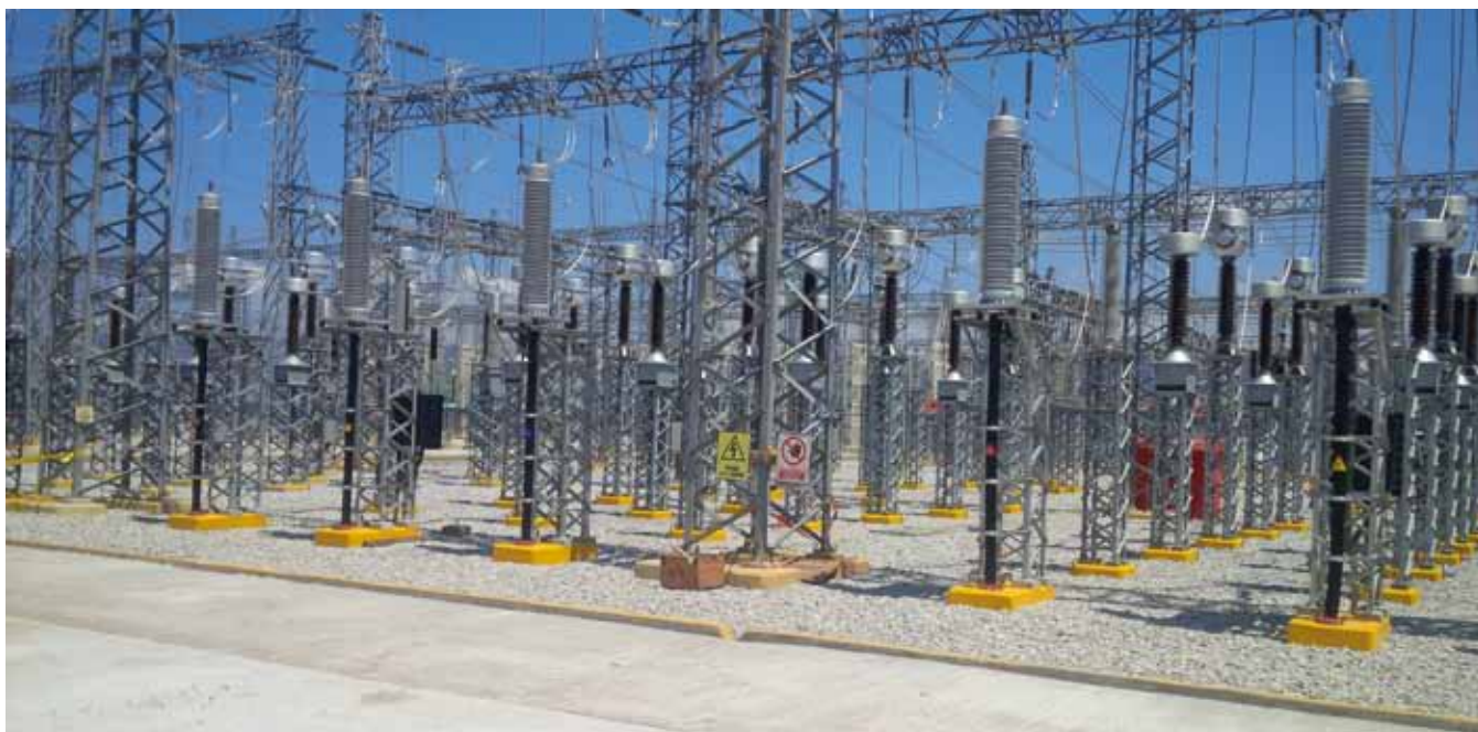
Trabajos eléctricos en el parque eólico Bii Hioxo de Juchitán de Zaragoza (Comsa Emte)
