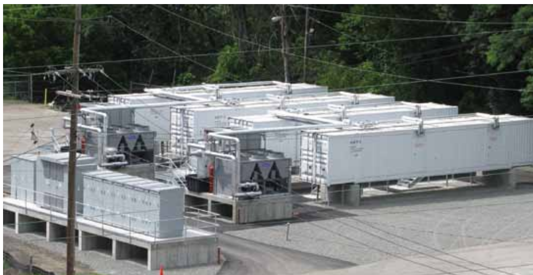
Fig. 4. Sistema industrial de baterías (34 MW) para soporte de instalaciones solares fotovoltaicas (Johnson City, California, EE. UU.)
