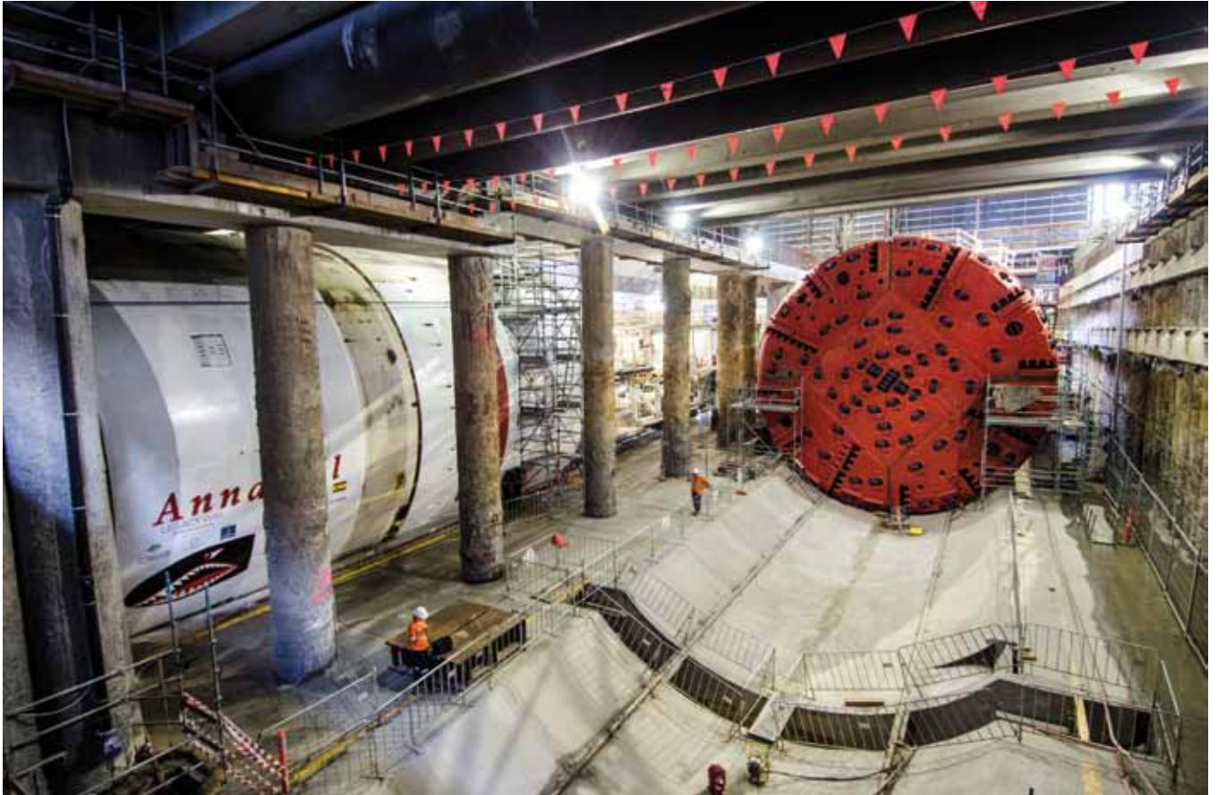
TBM instaladas en el portal de arranque
