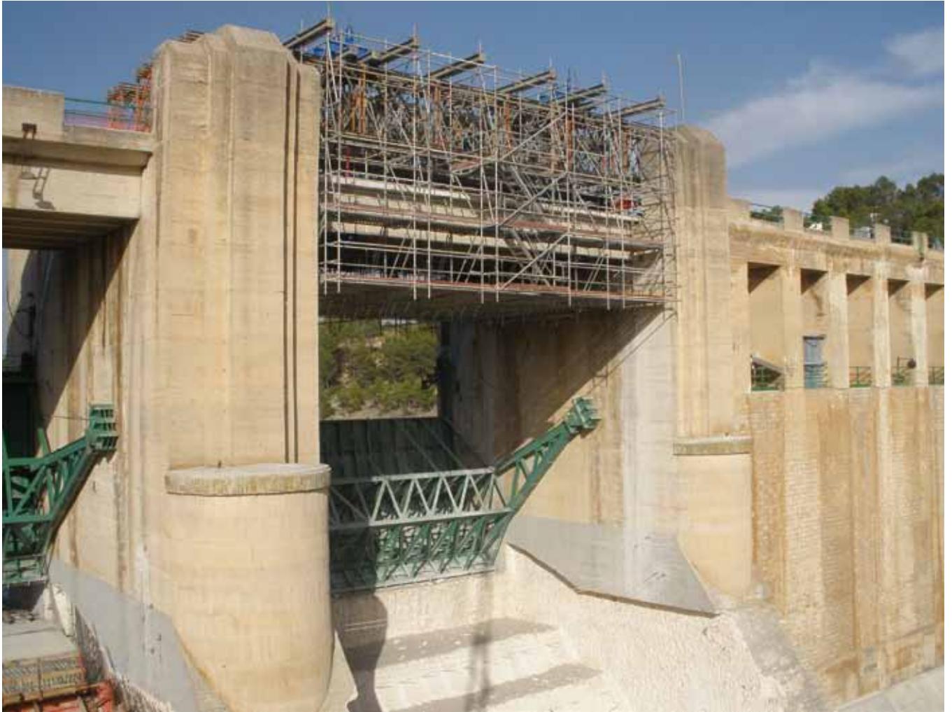
Fase de izado del tablero de la margen izquierda de la presa
