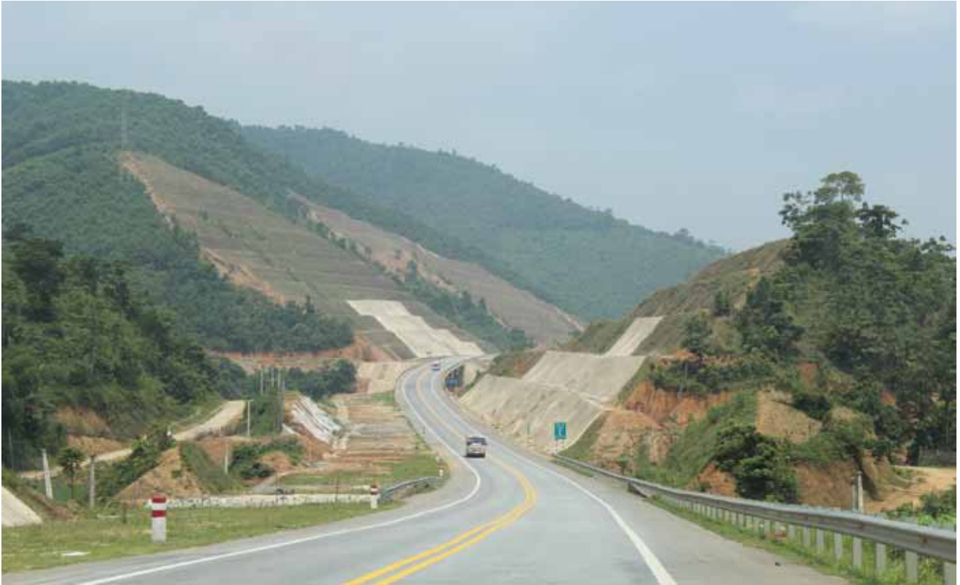
Desmontes de más de 100 metros de altura. Km 209. Sección Yen Bai-Lao Cai
