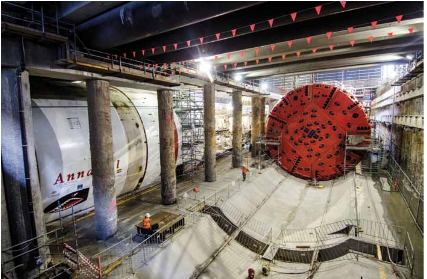
TBM instaladas en el portal de arranque
