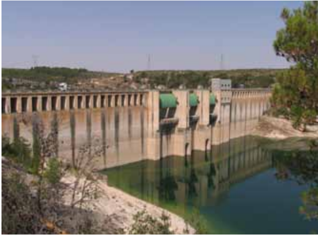
vista general de la presa desde aguas arriba. Estado inicial
