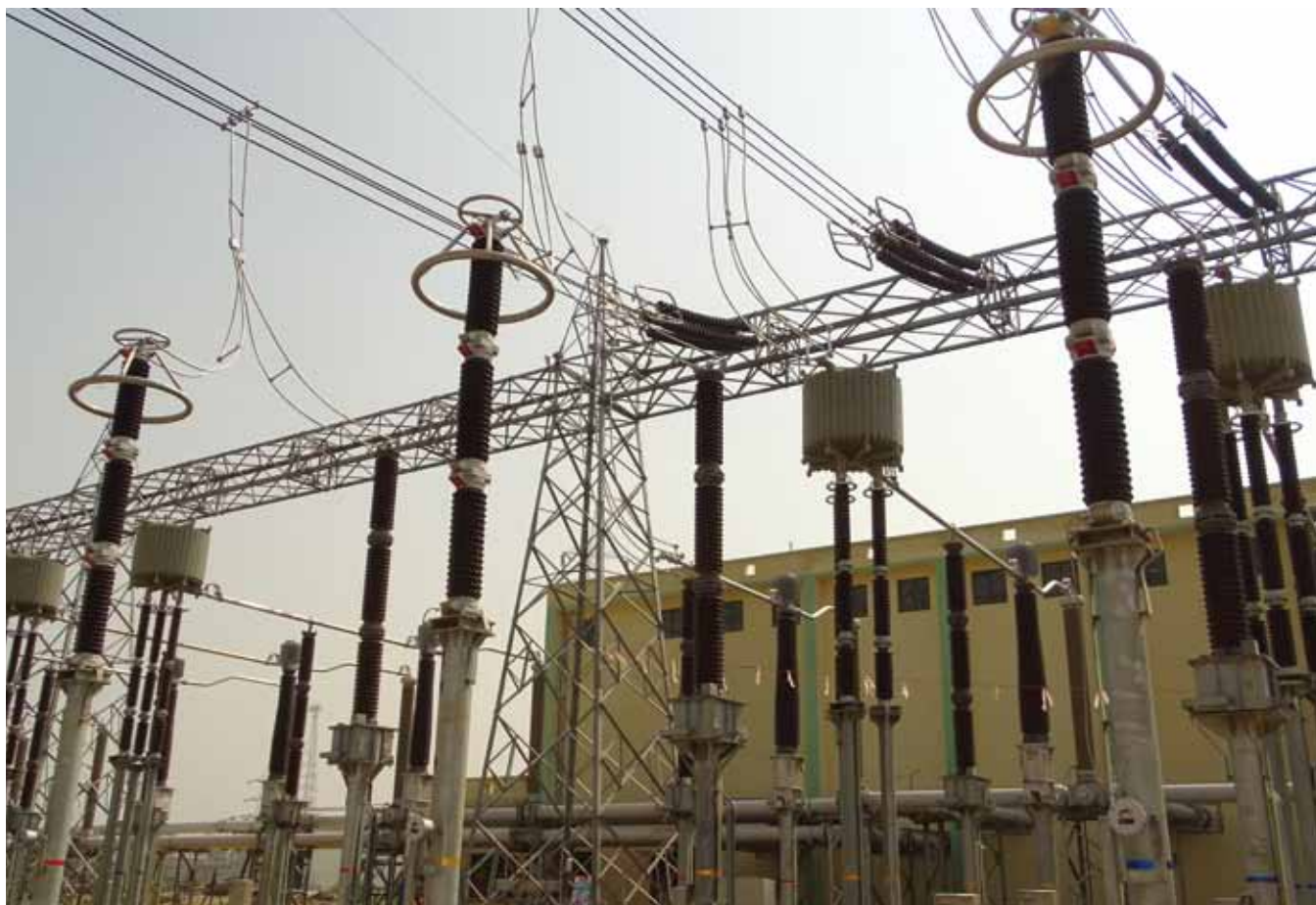
Subestación 40 kV GIS. Proyecto Bot Uttar Pradesh (Isolux Corsán)
