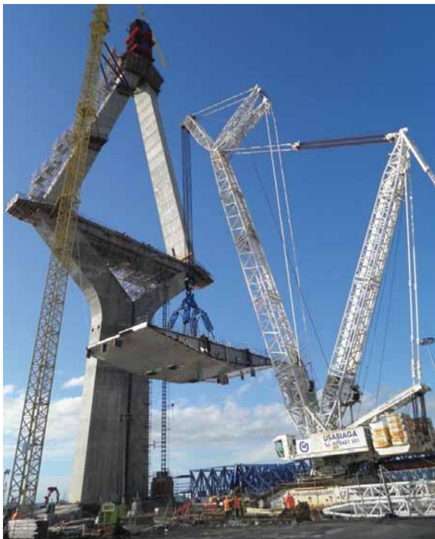
Izado de la primera dovela del tramo atirantado sobre la torre de tierra
