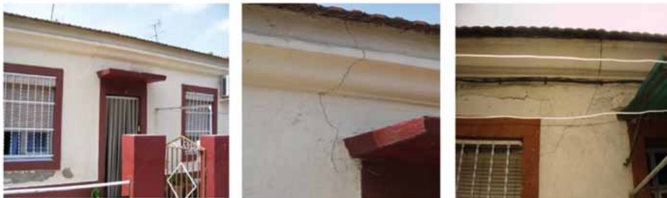
Fig. 8. Fisuras generadas en la fachada de las casas más próximas al eje del túnel
