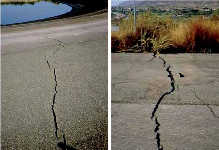
Fig. 6. Fallas por agrietamientos longitudinales y transversales en el cuerpo de la cortina, la corona y los revestimientos en la represa de Tolomó en Valencia, España. (Colectivo de Autores, 2009)
