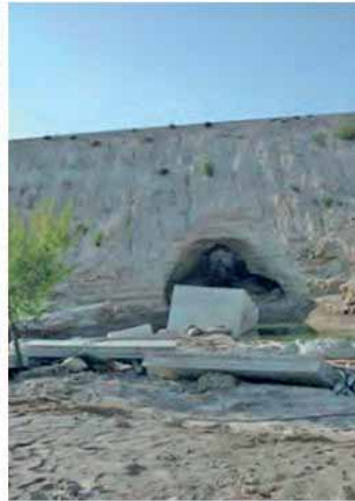
16. Falla por afectaciones a la obra de toma (Derrumbes, colapso, roturas, etc.). Vista de la Tubificación alrededor de las tuberías de la obra de toma (izquierda). Vista de la rotura anterior, desde el talud aguas abajo, (derecha). Dirección General del Agua de la Conselleria de Medi Ambient, Aigua, Urbanisme i Habitatge. Universidad Politécnica de Valencia, Universidad Jaume I de Castellón (2009)
