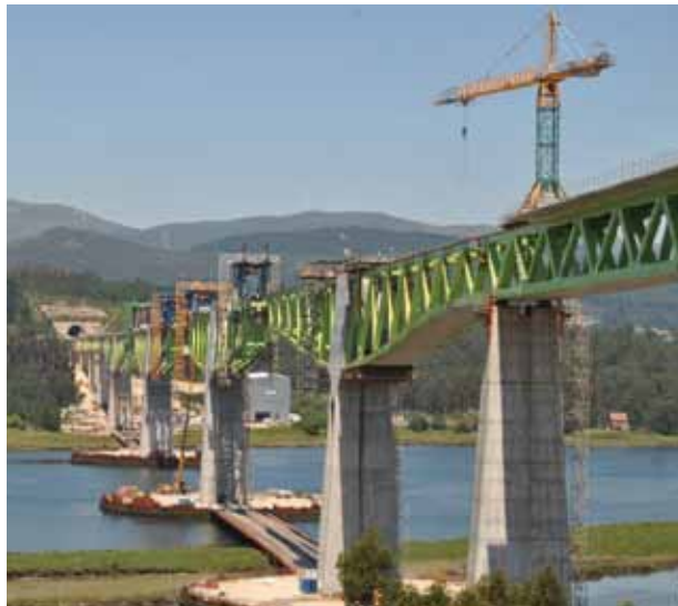
Fig. 6 PFU. Vista carros y plataformas sobre tablero en voladizo, y grúa torre sobre tablero en primer plano
