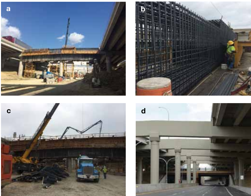
Fig. 13. a) Cimbra dintel in situ b) Detalle armado dintel c) Hormigonado de dintel d) Dintel finalizado
