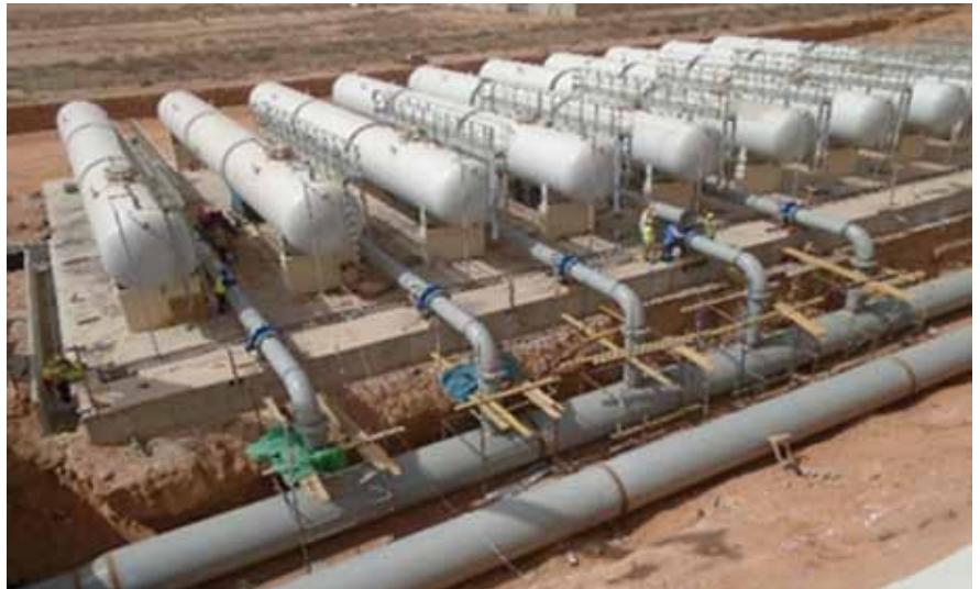
Detalle de la estación de calderines
