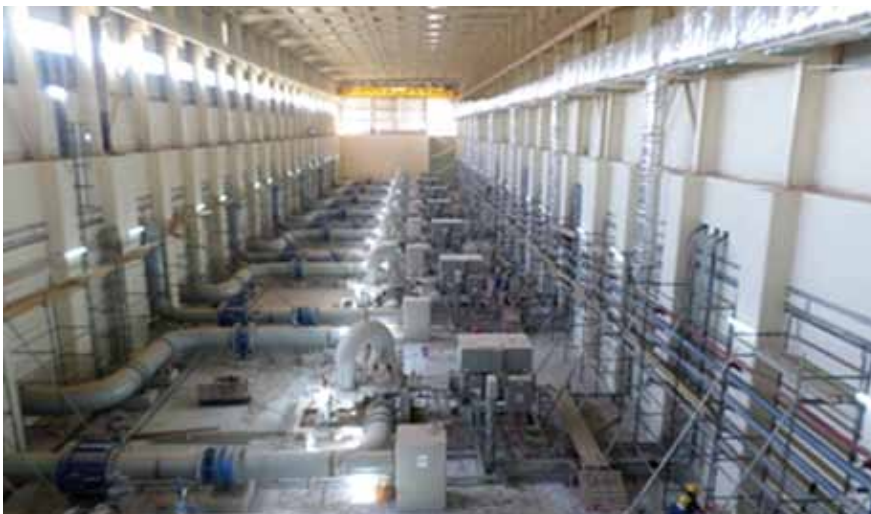
Detalle de la estación de bombeo
