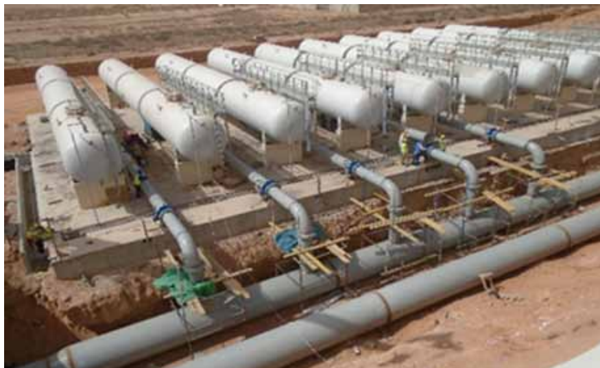
Detalle de la estación de calderines
