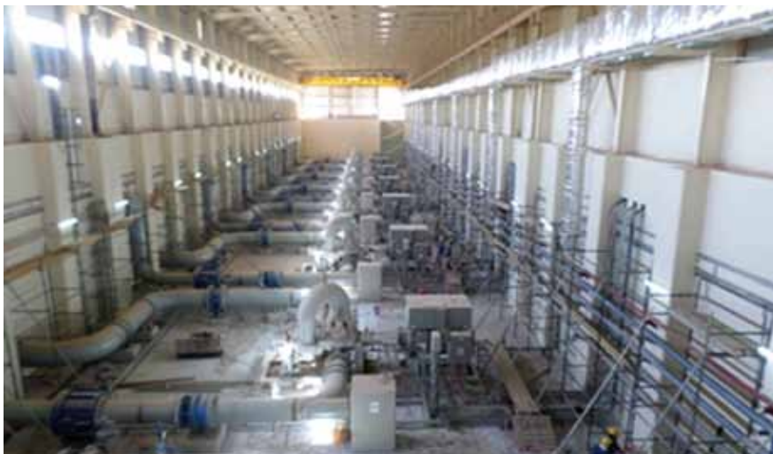
Detalle de la estación de bombeo
