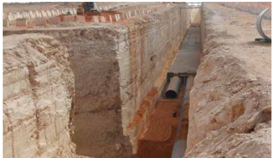
Detalle de conducción de acero al carbono
