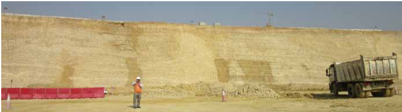
Fotografía 2. Excavación con fluencia de agua
