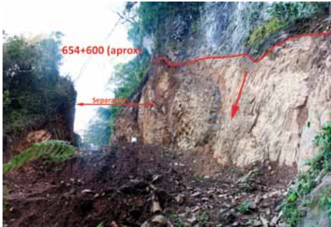
Fig. 1. Vista de la zona del colapso sobre la ladera. Nótese la separación entre bloques
