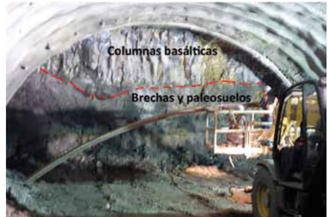
Fig. 2. Frente del túnel antes del colapso en el que se aprecia el contacto entre los basaltos columnares y el estrato arcilloso
