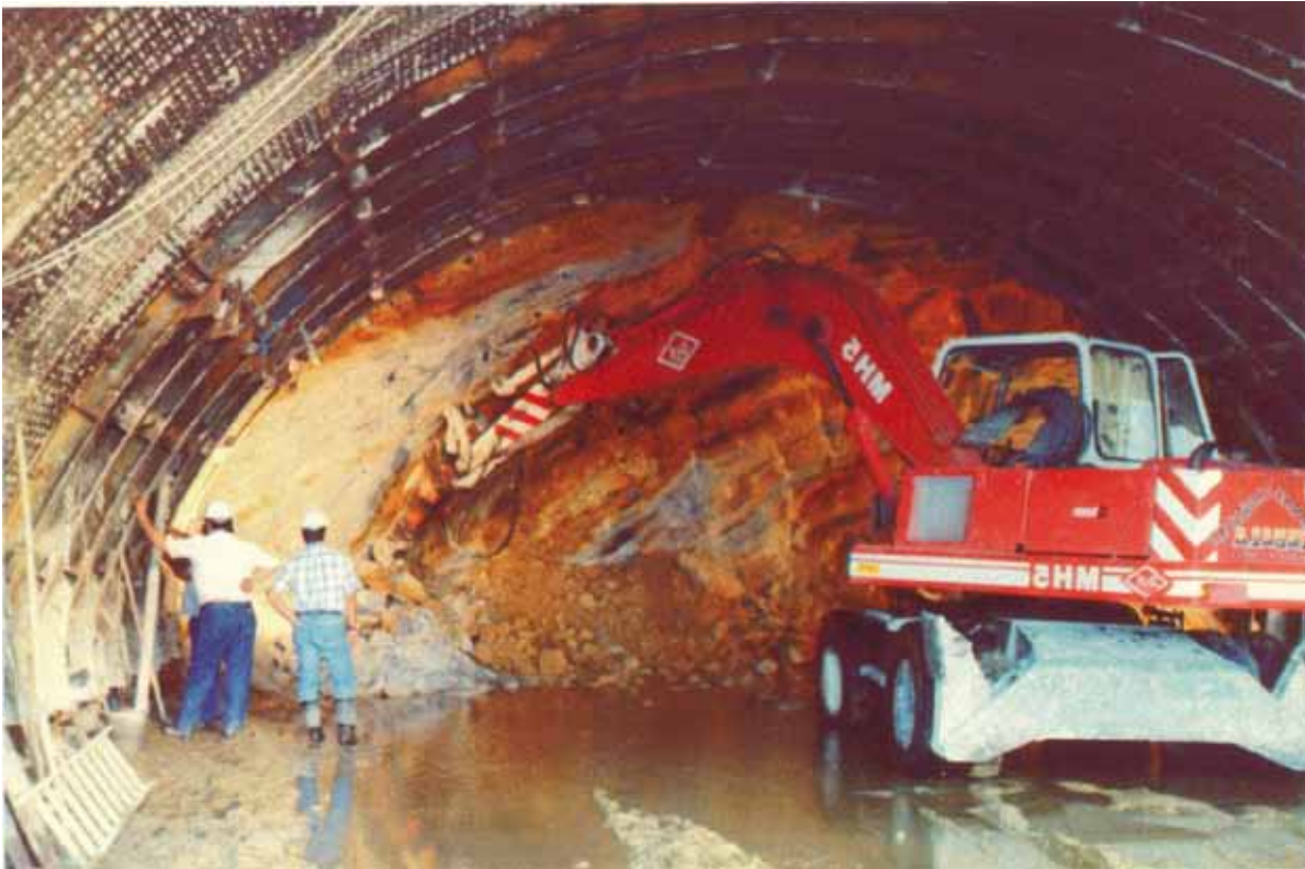
Fig. 9. Rotura en el frente. Túnel de Casimiro Sainz, Santander
