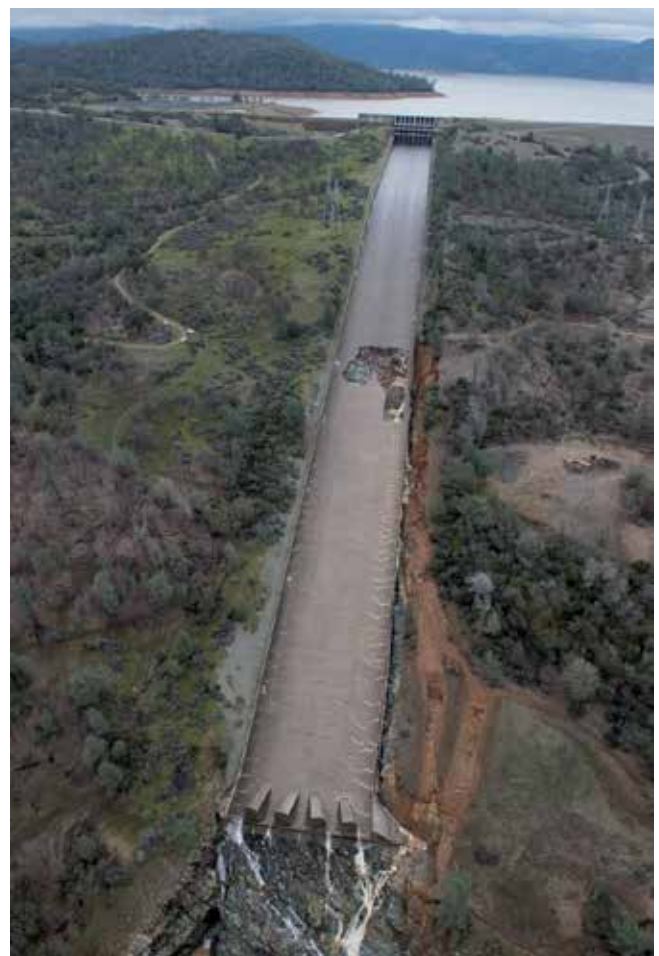
Fig. 7. Vista del aliviadero principal de la presa con el incipiente socavón en su zona central
