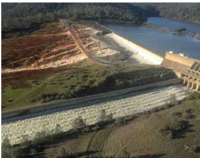
Fig. 2. Aliviadero principal (en primer término) y aliviadero de emergencia. La erosión en la ladera aguas abajo del aliviadero de emergencia es evidente
