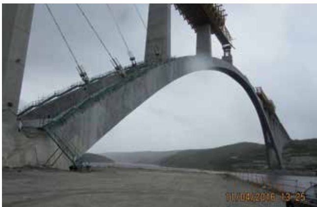
Fig. 32. Viaducto sobre el río Almonte en el embalse de Alcántara en construcción. Foto Arenas@Asociados.
