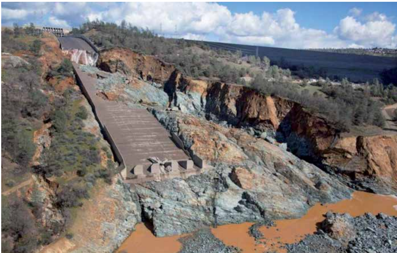
Fig. 13. Estado final del aliviadero principal de la presa de Oroville tras el incidente (27/02/2017)
