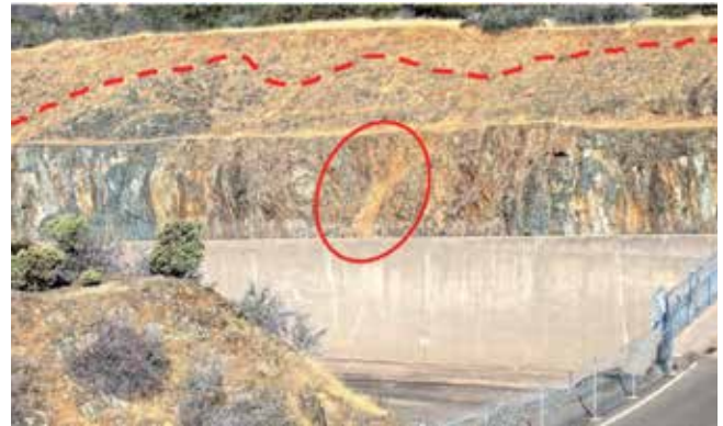
Fig. 6. Aspecto del terreno excavado junto a las compuertas del aliviadero principal, margen derecha
