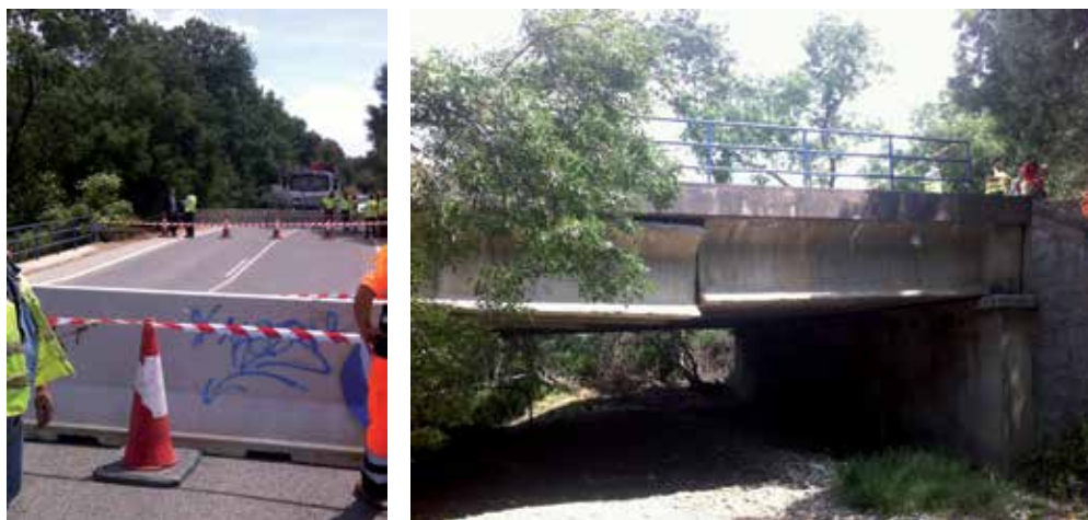
Fig. 10. El puente, ya cortado al tráfico y poco antes de desplomarse (29 de mayo a las 13.00 horas)
