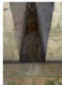
Humedades y filtraciones, librería 1, en Elemento Muro de guarda del Componente E1 (Deterioro 17)
