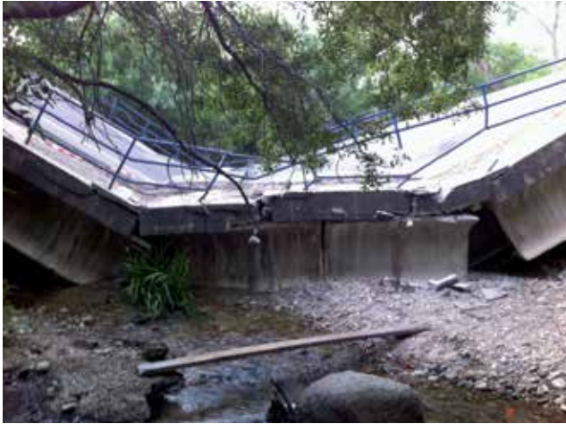
Fig. 21. Las roturas de las vigas tenían una configuración antisimétrica respecto al eje del tablero
