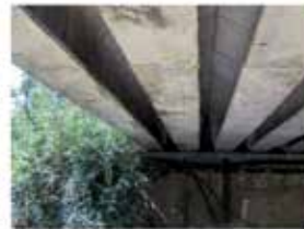
Efflorescencias, librería 1, en Elemento Vigas del Componente V1 (Deterioro 8)
