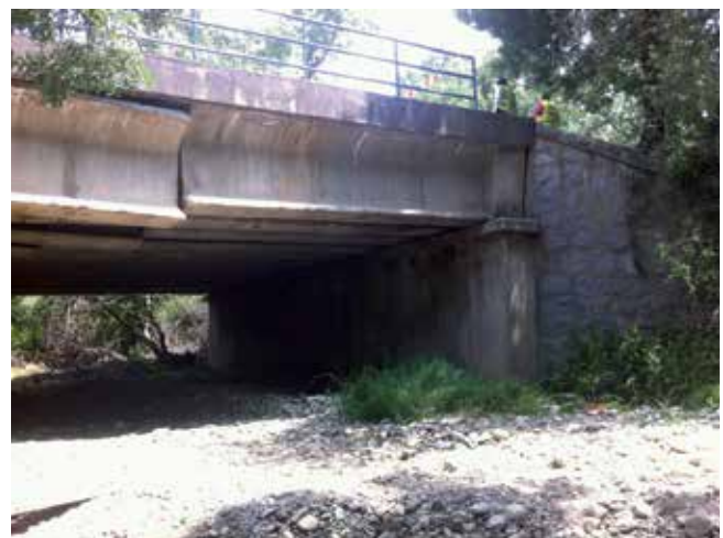
Fig. 11. El puente colapsado, minutos antes de desplomarse
