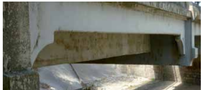
Fig. 13. Fotos de viga traviesa, y de viguetas-larguero, que forman en conjunto, la losa del tablero. La de borde de menor canto, y a continuación la de andén con mayor por el desnivel, y la central o de calzada. En primer término, el larguero de borde, muestra una grieta en la escuadra, que le une a la traviesa
