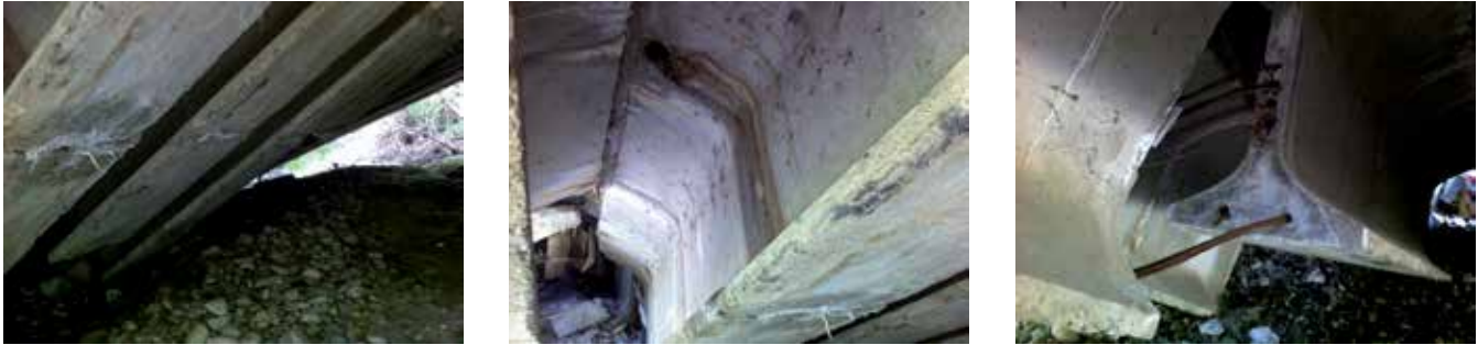
Fig. 14. Vigas interiores: carbonatación en las juntas y corrosión en los alambres
