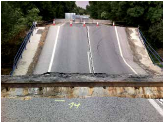
Fig. 1. El puente colapsado, el 5 de junio de 2015
