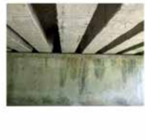
Humedades y filtraciones, librería 8, en Elemento M.F. portante del Componente E1 (Deterioro 18)
