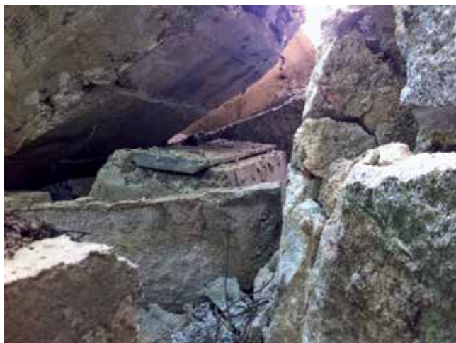
Fig. 8. Detalle de los apoyos móviles, según el proyecto [4] y parte superior de uno de los péndulos de apoyo, tras la caída
