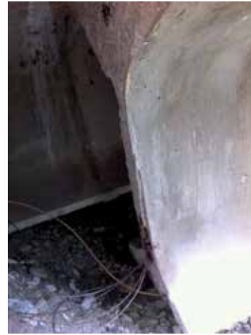
Fig. 22. La mala ejecución de las juntas y la deficiente inyección de las vainas precipitaron la corrosión de los alambres
