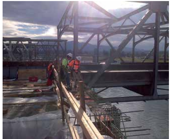
Fig. 27. El colapso y la reparación del puente sobre el río Skagit (WSDOT, en www.flickr.com )
