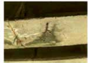
Desconchones/lagas (con armadura pasiva implicada), librería 6, en Elemento Vigas del Componente V1 (Deterioro 9)
