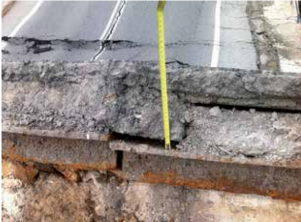
Fig. 18. El espesor de pavimento llegaba a superar los 25 cm
