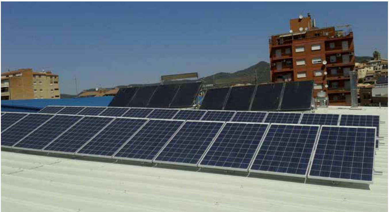
Instalación en la escuela Dr. Ferrer de Artés. Fuente: SUD Energías renovables
