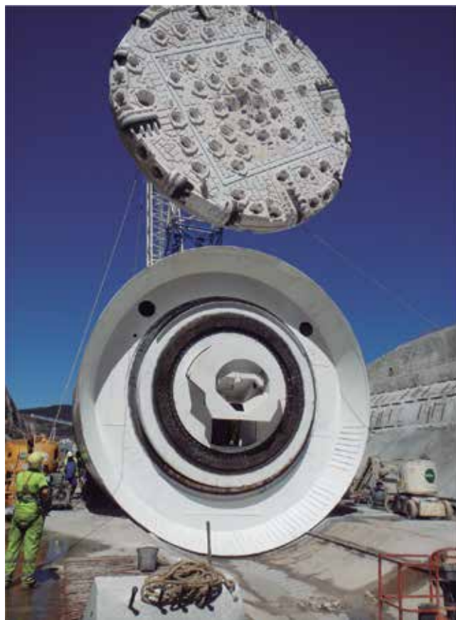
Fig. 3. Rueda de corte con pletinas antiabrasión de 30 mm de espesor en el cono de entrada del escombros
