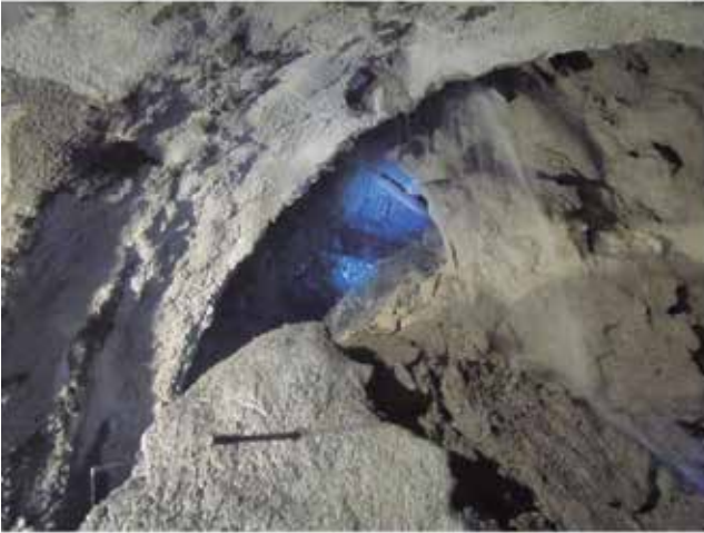
Fig. 5. Fallo parcial en el pase en hombro derecho p. k. 401+740 –a la izquierda de estas líneas–
