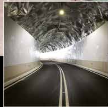
Carretera CV-428. Cortes de Pallás, Valencia Supervisión de las obras de acondicionamiento.
