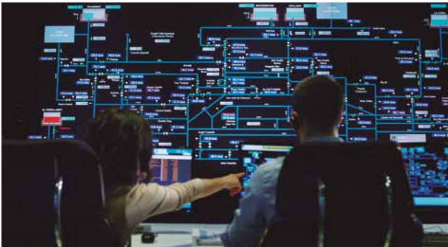
Fig. 5_ Centro de telemando del abastecimiento de Valencia en Vara de Quart
