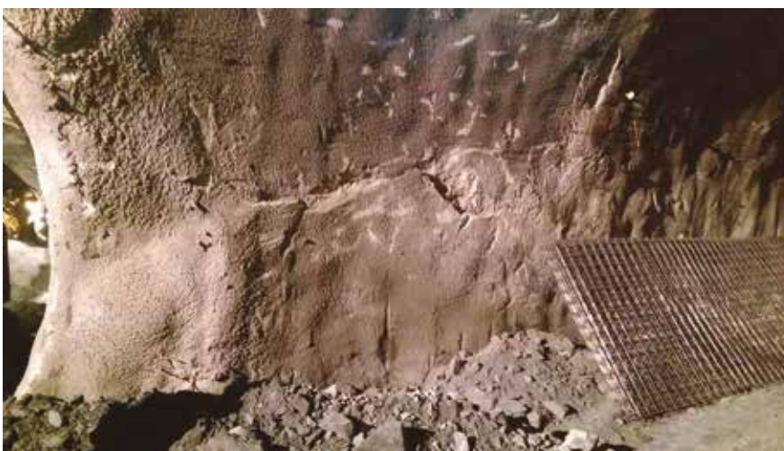
Fig. 26. Convergencia en el entorno de la progresiva 893+865
