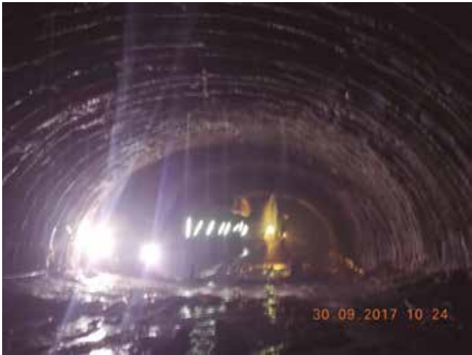
Fig. 30. Filtraciones en lado Oeste del Túnel
