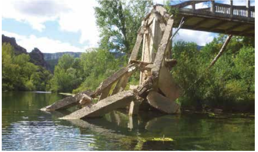
Herido de muerte. el tramo se retuerce en el río fuera de la pila izquierda. Postrado, muestra la rotura del puente en la clave de los dos arcos, y las riostras enteras desprendidas
