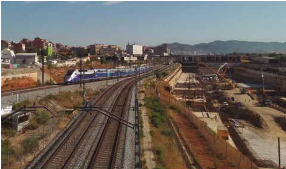
Obras de construcción de la futura Estación Intermodal de La Sagrera, rodeadas por los trazados provisionales de la línea de alta velocidad y las líneas de la red convencional. Fuente: elaboración propia
