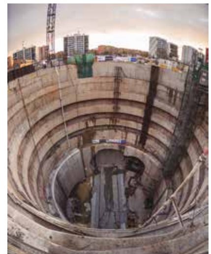
Fig. 4_ Cale tuneladora de 12 m de diámetro en un pozo de estación. Construcción estación profunda L9
