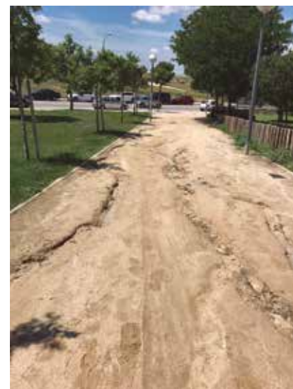
Cárcavas y drenaje deficiente en zonas verdes
