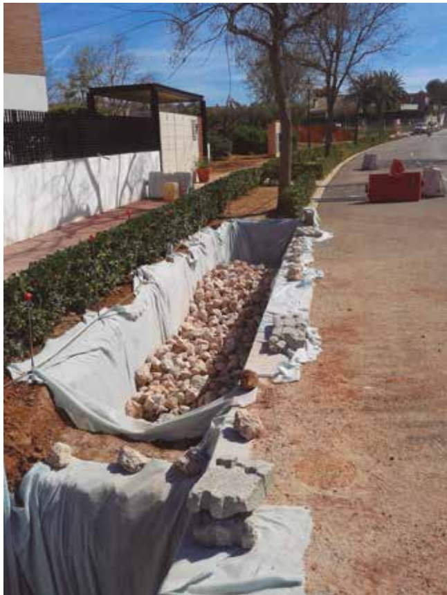
Cunetas filtrantes en calle Cotolliu
