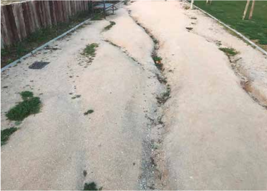
Cárcavas y drenaje deficiente en zonas verdes
