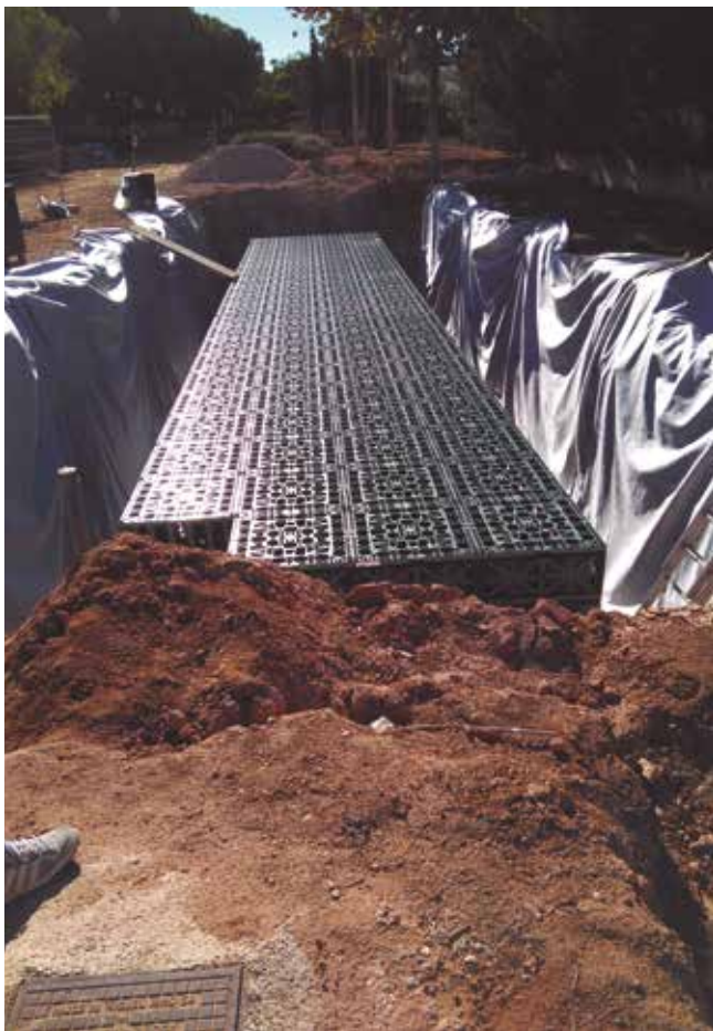
Depósito en Mas Camarena: bloques de infiltración
