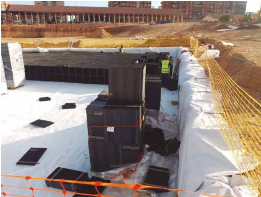
Fig. 2_ Esquema de montaje de las celdas de polipropileno del depósito de infiltración en el Parque Central
