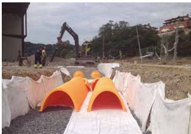
Fig. 3_ Instalación de bóvedas Stormtech para la infiltración-laminación de las aguas de escorrentía
