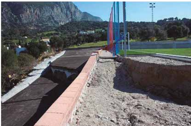
Fig. 1_ Daños producidos por deslizamiento
