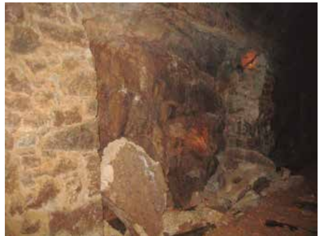
Fig. 16_ Ausencia de sostenimiento en hastiales
