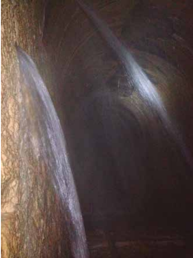
Fig. 17_ Filtraciones de agua ("Anteproyecto constructivo de obras para restauración y acondicionamiento del túnel de Laminoria en el trazado de la vía verde del antiguo ferrocarril Vasco-Navarro". Marzo 2014. CRS Ingeniería)
