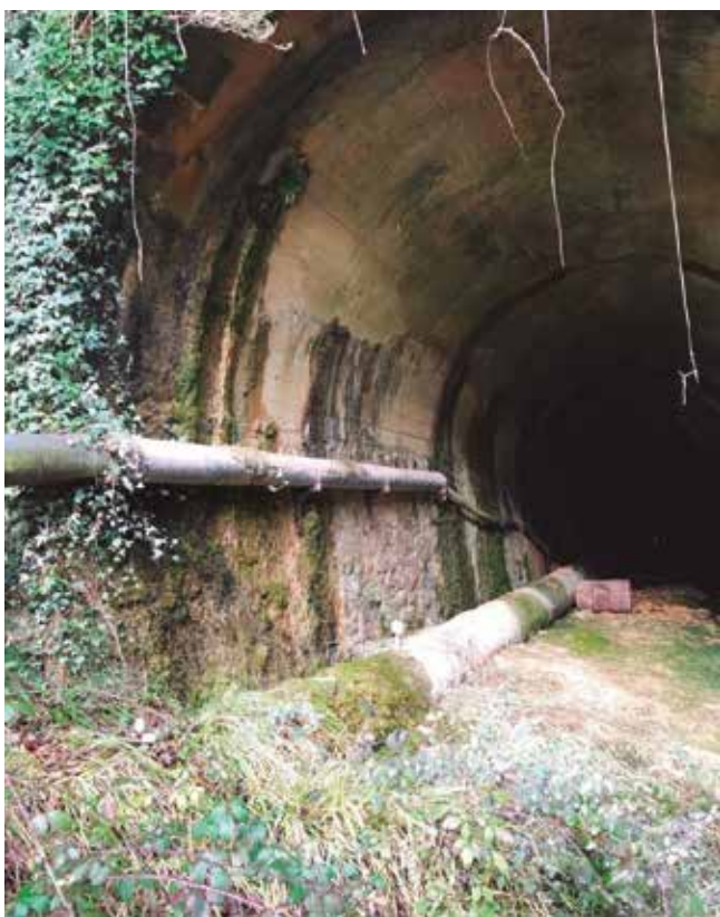
Fig. 4_ Tubería de abastecimiento (Boca Sur)
