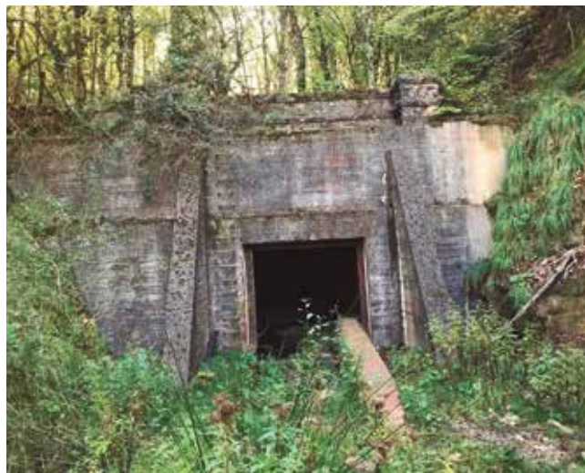
Fig. 5_ Tubería del trasvase (Boca Norte)
