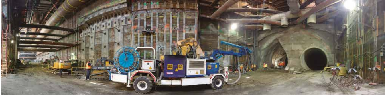
Fig. 5_ Excavación de la galería izquierda vista desde la estación de 2nd / Broadway
