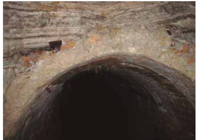
Fig. 15_ Huecos entre revestimiento y roca
