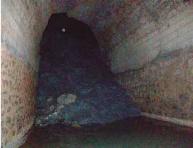
Fig. 6_ Desprendimiento de bóveda
