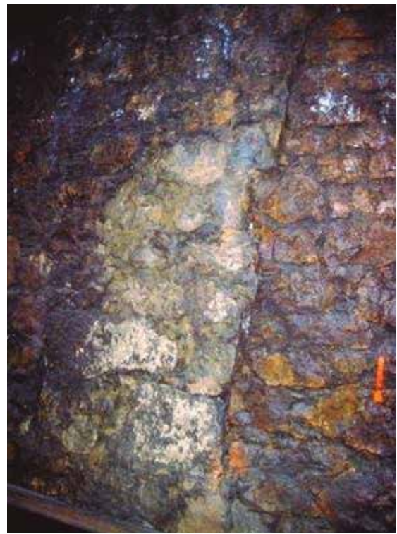
Fig. 10_ Abombamiento de hastial de mampostería
