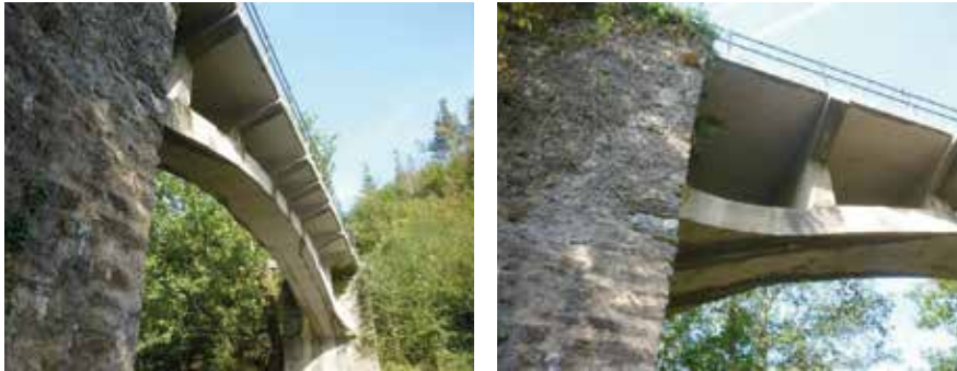
Fig. 12_ Dos imágenes actuales del arco en su desarrollo y del estribo, mostrando ambas detalles de su esbeltez y de la construcción de los montantes y travasas en ménsula, en su diseño y ubicación
