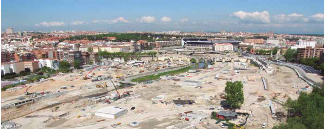
Ejecución de las obras con el desaparecido Estadio Vicente Calderón al fondo
