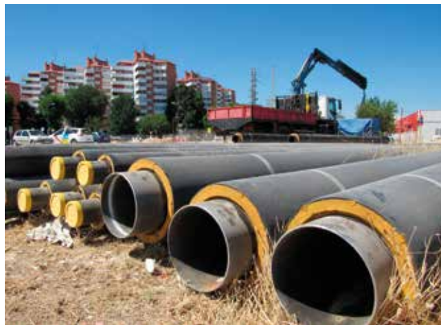
Tuberías preaisladas utilizadas en la red de distribución
