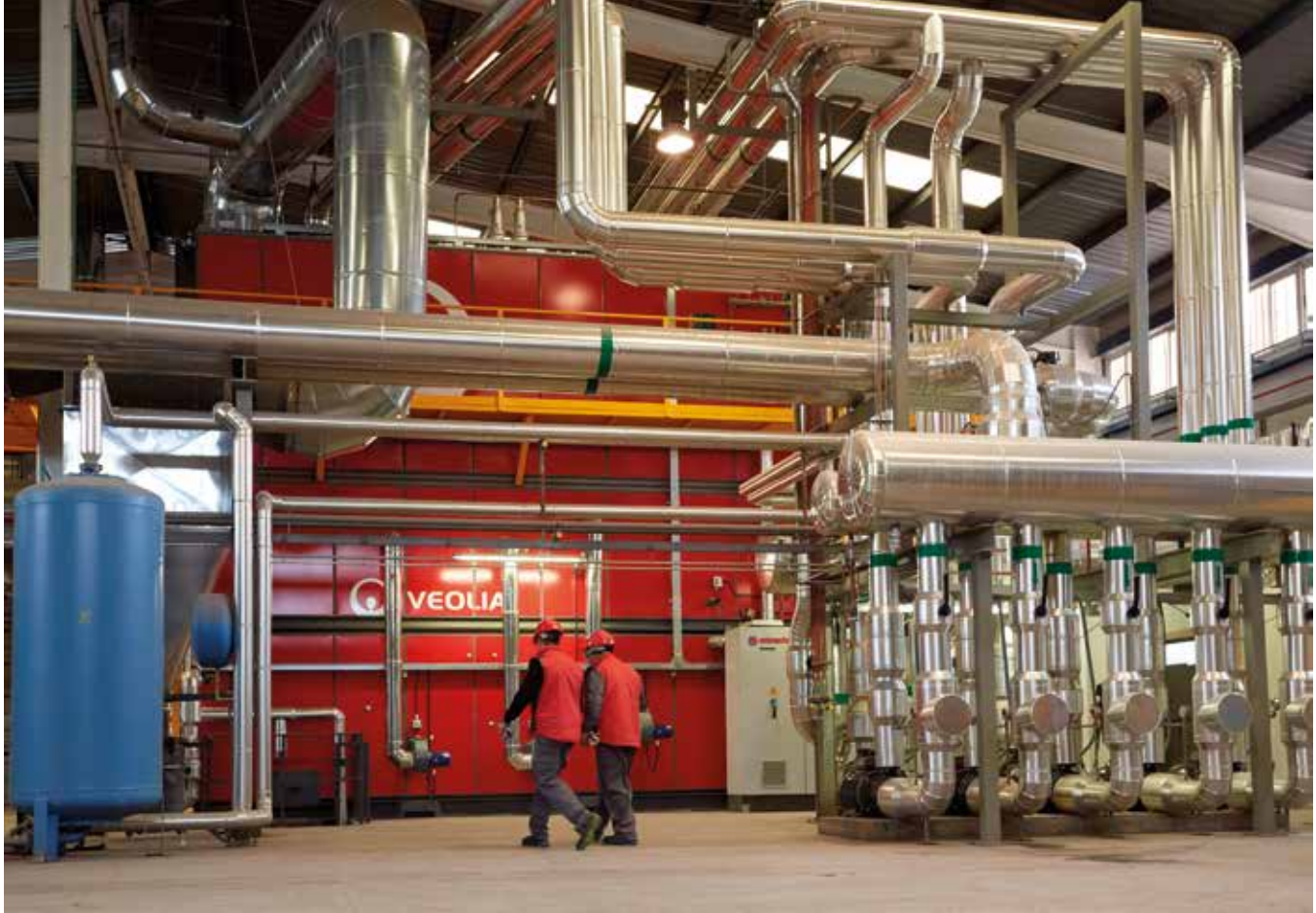
Interior de la central de producción
