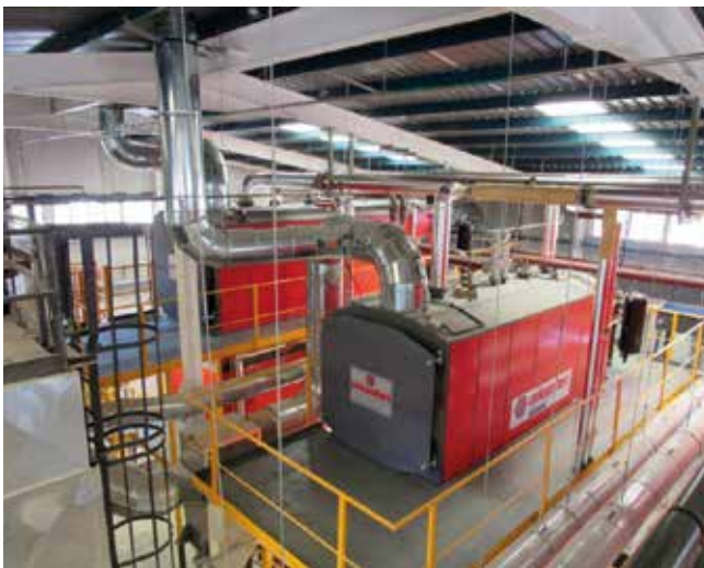
Calderas de biomasa en el interior de la central de producción
