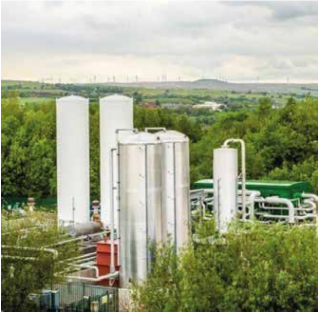
Fig. 1_ Planta de demostración (15 MWh) en Reino Unido Fuente: Highview Power
