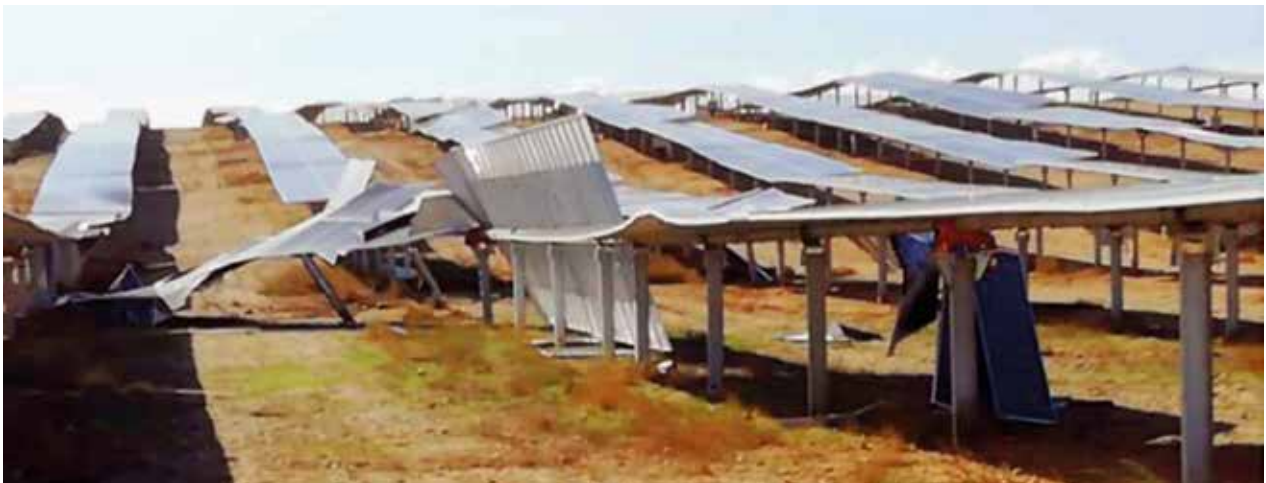
Fig. 21_ Siniestro de trackers y paneles en planta monojeje. Fuente: Es Energía
