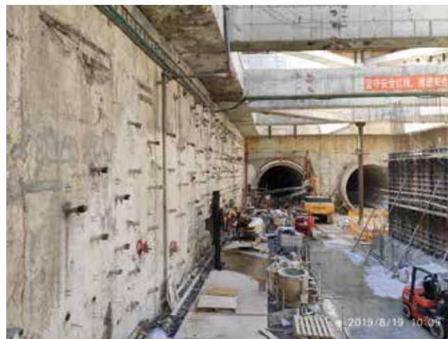
Fig. 2_ Pantalla del pozo con las válvulas de inyección
