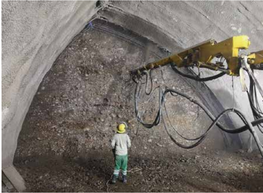
Fig. 3.1.c_ Proyección de shotcrete a 6 bar de presión de aire y caudal de proyección de hormigón de 6 m 3 /h
