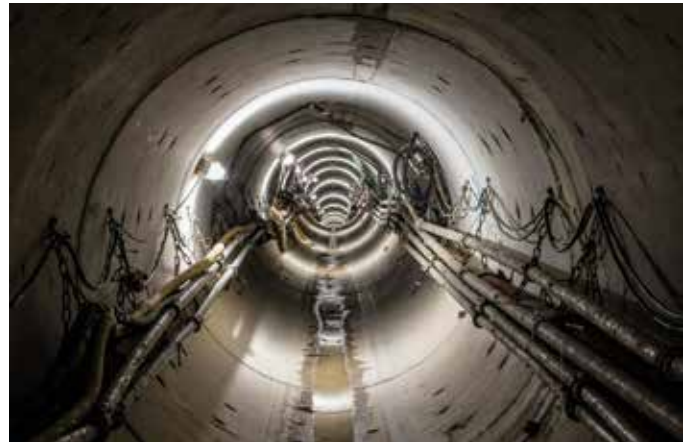
Foto 3_ Curva izquierda hinca de Sonntag en Zug, Suiza. Fuente: Herrenknecht (izda.) Foto 4_ Curva vertical negativa hinca de Sonntag en Zug, Suiza. Fuente: Herrenknecht (dcha.)
