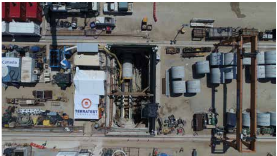
Foto 2_ Vista del pozo de lanzamiento emisario submarino México, Terratest Tunnelling. Fuente: Herrenknecht
