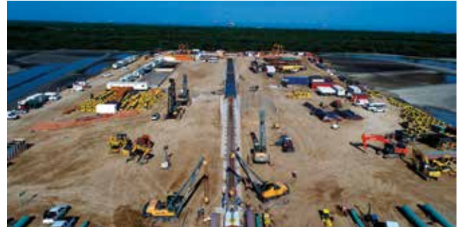
Foto 9_ Trabajos de conexión del cabezal de tipo en rampa para la instalación del primer tramo del gasoducto, al fondo de puede apreciar la rampa completamente inundada
