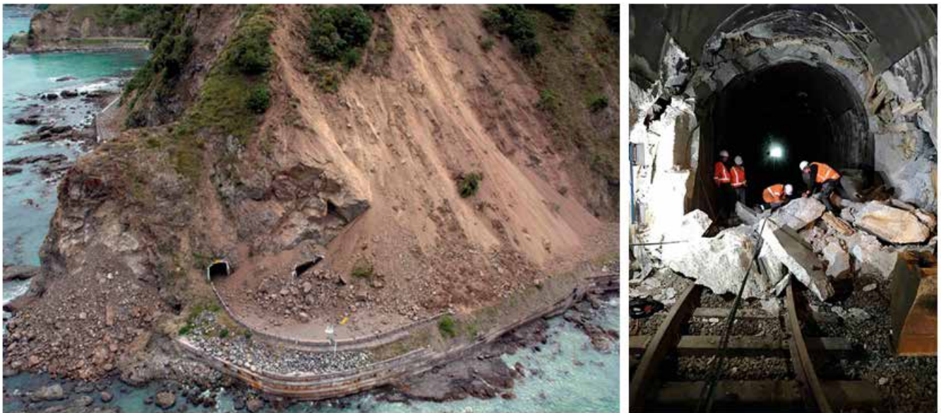
Fig. 3_ Daños causados por el terremoto de Kaikoura (Nueva Zelanda, 2016): deslizamientos de taludes y rotura del revestimiento de un túnel ferroviario. Fuente: New Zealand Transport Agency (NZTA, [internet])
